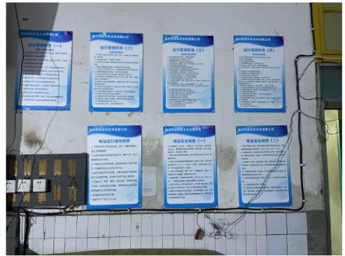
机房相关制度
